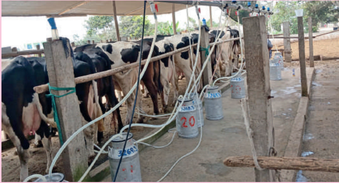
Seguimiento de rutina de ordeño, instalación de la nueva máquina de ordeño proveedor Agropecuaria PCL, a cargo del asesor técnico de campo Jorge Sánchez.
